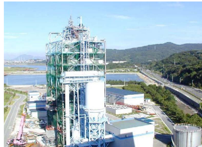
日本飞鹰IGCC电站项目 H25X1台
