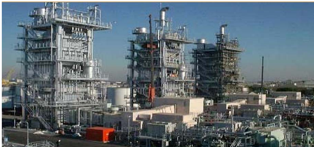
日本千叶县五井海岸电厂H25x3台
